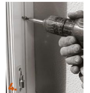
4. Fixation du nouveau dormant par vérins réglables ou par vissage en applique et réalisation d'une étanchéité périmétrale.
